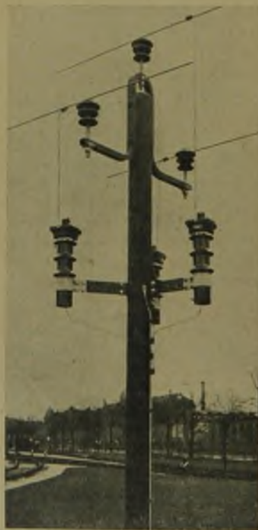
Rys. 7. Odgromniki katodowe SSW na napięcie robocze 15 000 woltów, zainstalowane na linii napowietrznej.
