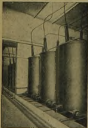
Rys. 7. Odgromniki różkowe typu SSW na napięcie robocze 60000 V (oporniki z elektromagnesami umieszczone są w widocznych na zdjęciu kotłach).
