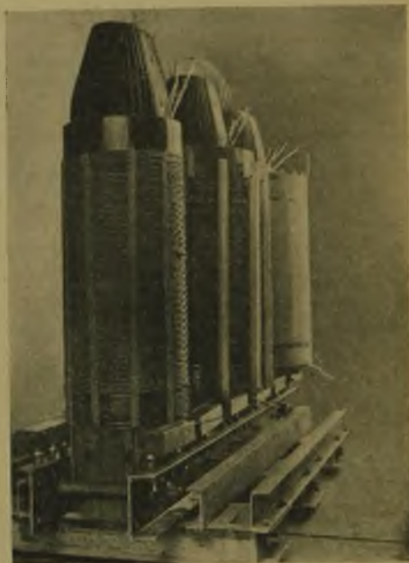
Rys. 3. Transformator 3 000 kVA, 60 000/15 500/6 400 V w czasie montażu (Elektrobudowa).
