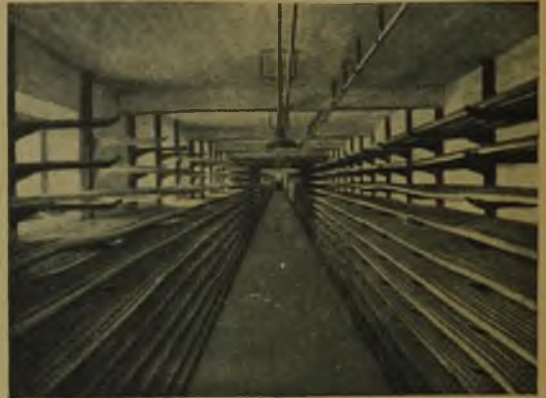
Rys. 1. Korytarz kablowy w elektrowni Klingenberg (Niemcy). (wdg. AEG)
