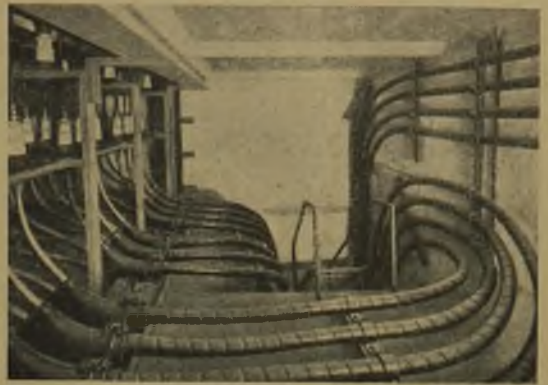
Rys. 5. Układ kabli w elektrowni „Else” (Niemcy). (wg. AEG).
