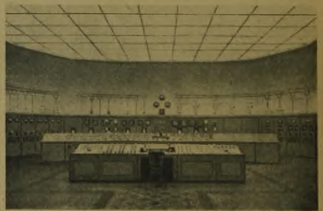
Rys. 1. Nowa nastawnia w elektrowni łódzkiej.
