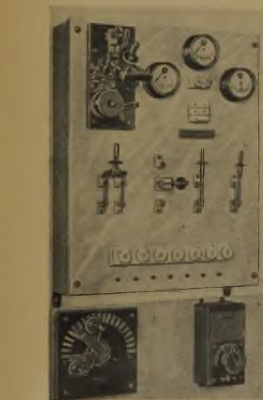
Rys. 20. Widok tablicy rozdzielczej dla małej instalacji prądu stałego.
