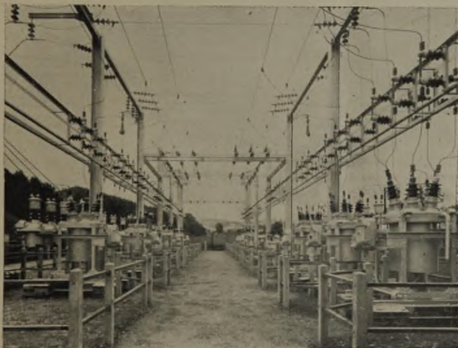
Rozdzielnia napowietrzna dla napięcia 15/30 kV.
