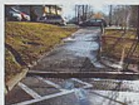
Miejsce styku ciągu pieszo-rowerowego ze strefą wejściową
