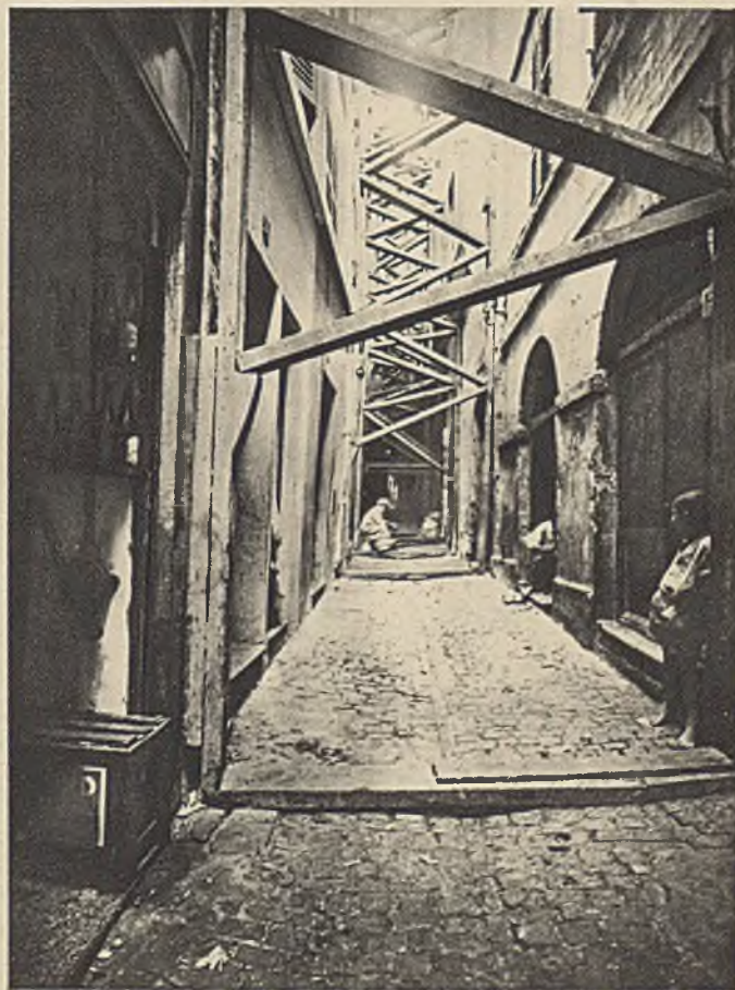
Rue du quartier de la Marine, toutes les maisons ont dû être étayées pour éviter l'écrasement. Photo de LOUVENCOURT
