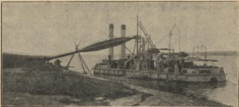
Ryc. 209. Draga ssąca (refuler) „Mamut“ (dawniej „Cruachon“), zakupiona w Anglii. Z lewej strony zmontowany rurociąg tłoczny, z prawej strony ssak, zapuszczony w dno.
