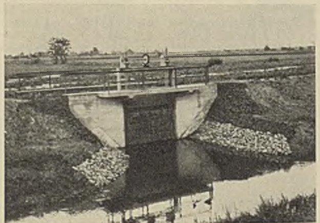
Abb. 3. Sperrbauwerk im Entwässerungsgraben. Bei Hochwasser wird das Schütz geschlossen und der Polder durch Pumpen entwässert.
