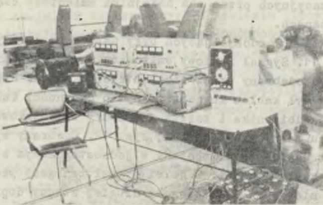
Rys. 12. Widok zblokowanej aparatury odbiorczej zainstalowanej w pomieszczeniu maszyny wyciągowej
