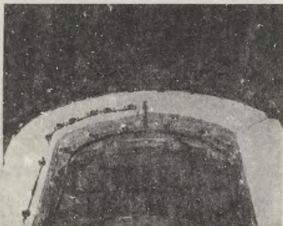
Zdjęcie 3. Zdeformowane sklepienie w obudowie murowej o kształcie jak na zdjęciu 1 ( h/2l = 0,25 < 0,3 ) lecz przy większej grubości muru, d = 38 cm. Sklepienie obudowy zdeformowane przy dużym obciążeniu q_1 i małym q_2
