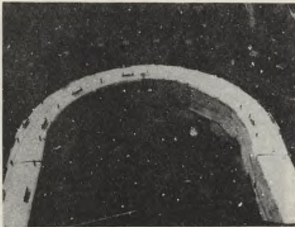
Zdjęcie 6. Obudowa murowa z pękniętymi murami prostymi pod wpływem dużego obciążenia obudowy w kierunku pionowym i poziomym. Pęknięcia w sklepieniu powstały po zewnętrznej jego stronie w otoczeniu kluczowego przekroju sklepienia
