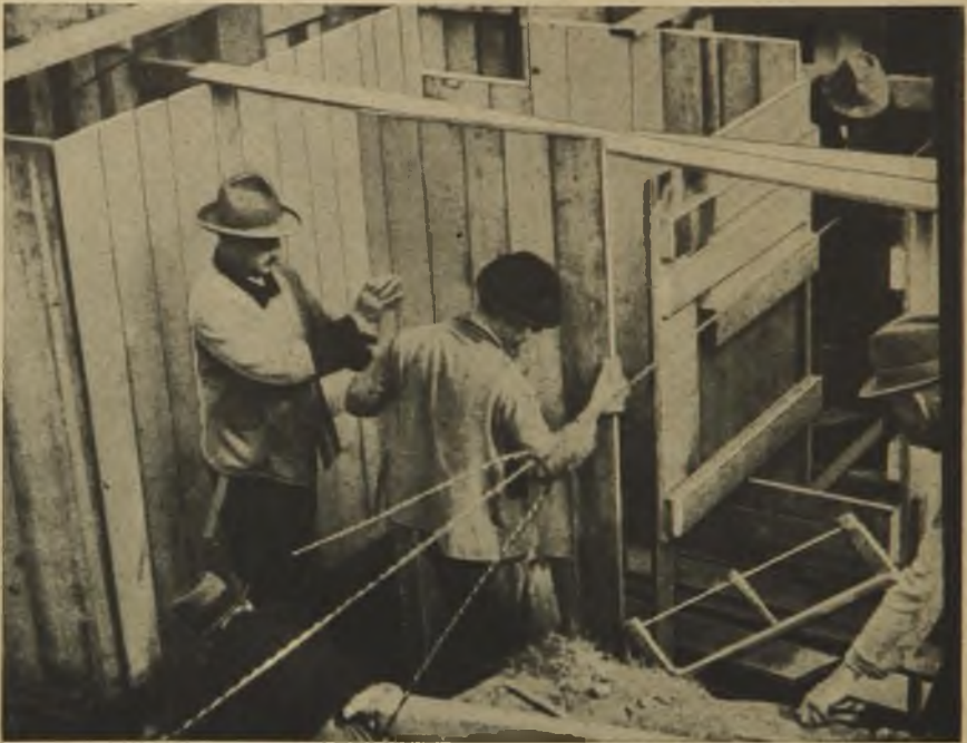
Das Zuschneiden und Aufstellen der Holzverschalung für die Betonbauten ist Arbeit der Zimmerleute. Nur geübte Facharbeiter können eine den Bauzeichnungen genau entsprechende Arbeit liefern.
