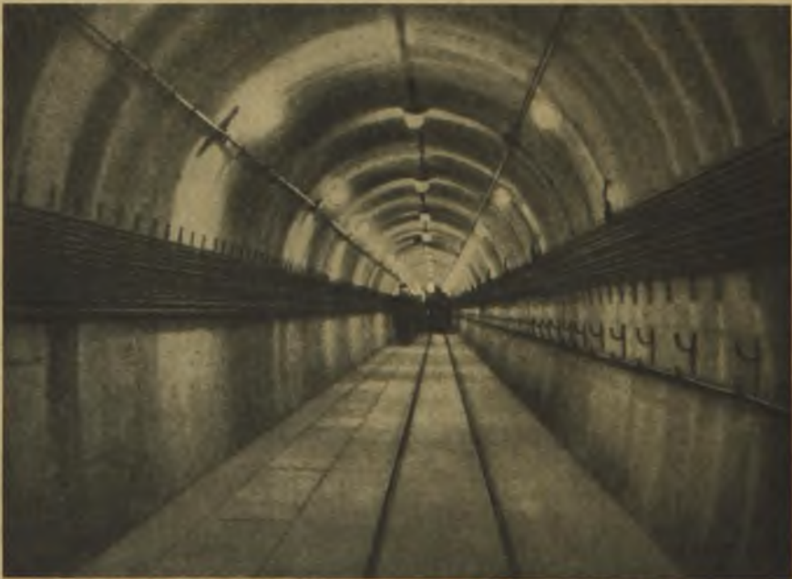
In den taghell erleuchteten Hohlgängen verlaufen Licht- und Fernsprechkabel.
