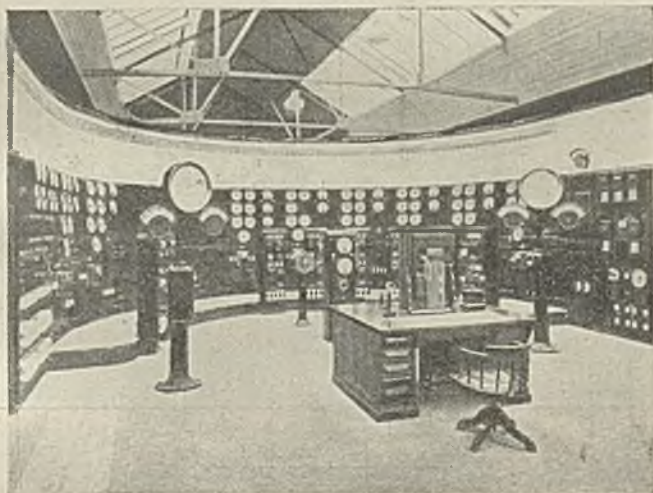
B. NASTAWNIA ELEKTROWNI TRAMWAJOWEJ w Liverpoolu
