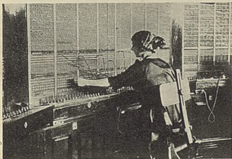
FRAGMENT WIELKIEJ RĘCZNEJ CENTRALI TELEFONICZNEJ
