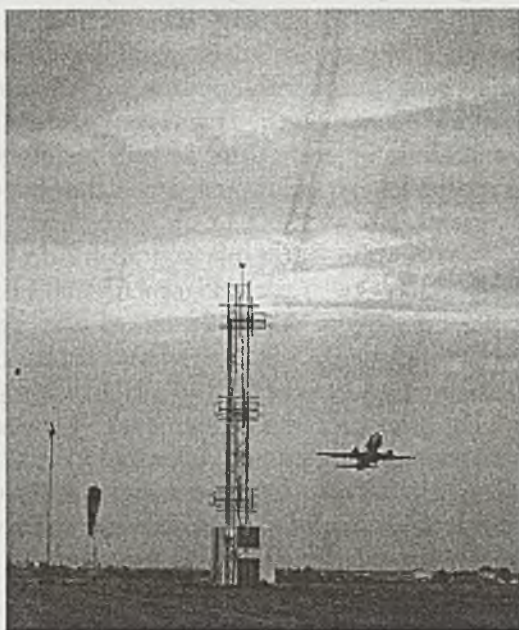
Rys. 2. Instalacja naziemna ILS [2]
