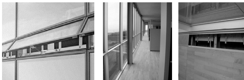
Rys. 6.68. Otwory wlotowe i przyokienne nagrzewnice powietrza nawiewanego w biurze Bang & Olufsen
