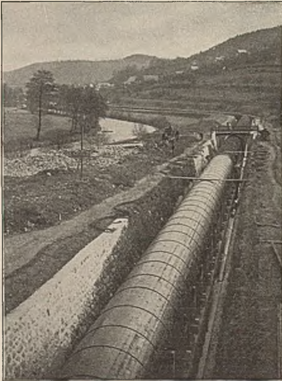
Abb. 486. Turbinendruckwasserleitung. 2,75 m Durchmesser, der Papierfabrik Grohmann in Klein Wöhlen bei Bodenbach. (Hergestellt von der Deutschen Holzröhren A.-G., Hannover, „Deuhrag“).
