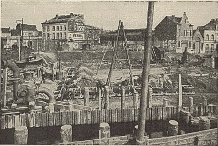
Abb. 216. Sandaufquellungen beim Bau eines Trockendocks. (Nach Schonopp, Bautechnik 1926.)
