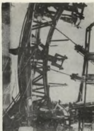
Rys. 25. Zdeformowane łuki ociosowe obudowy ostrołukowej
