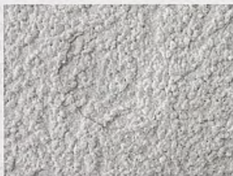
Rys. 1. Uszkodzenia warstwy wyprawy tynkarskiej
