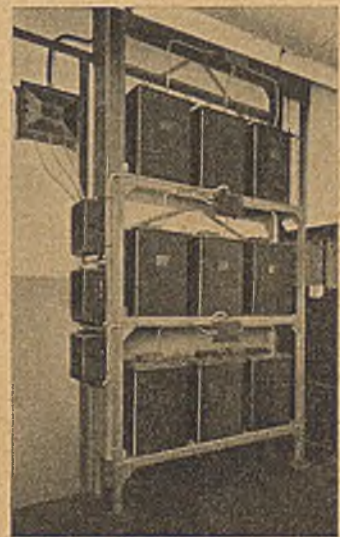
Abb. 45. Starkstrom-Kondensatoren-Anlage für 130 kVA, 380 V, 50 Hz.
