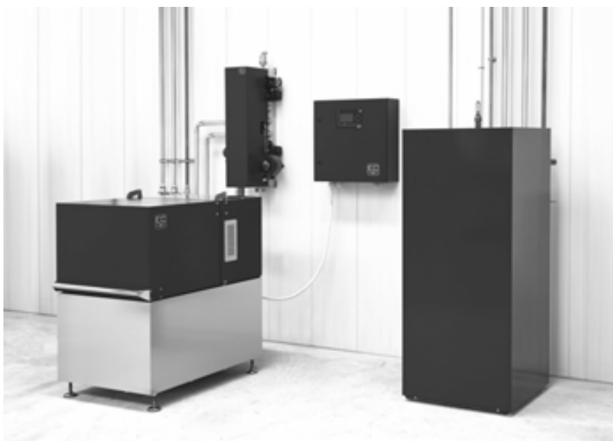
Rys. 7.3 Zestaw gazowej mikrokogeneracji MCHP XRGI
