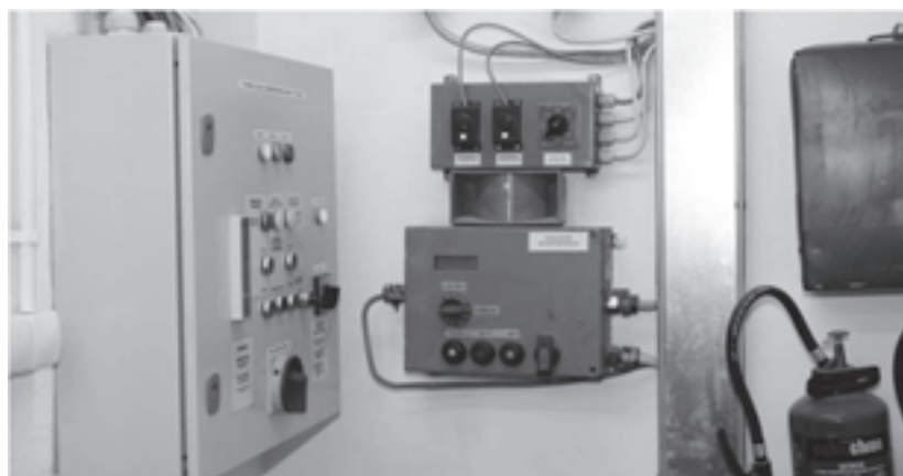
Rys. 21.11 Stanowisko do kontroli parametrów mikroklimatu i pracy komory
