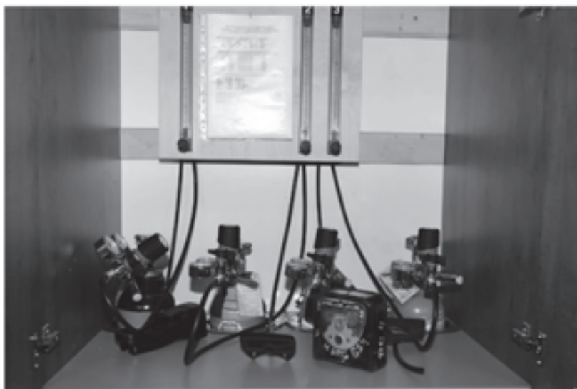
Rys. 21.8 Stanowisko do kontroli przyrządów gazometrycznych
