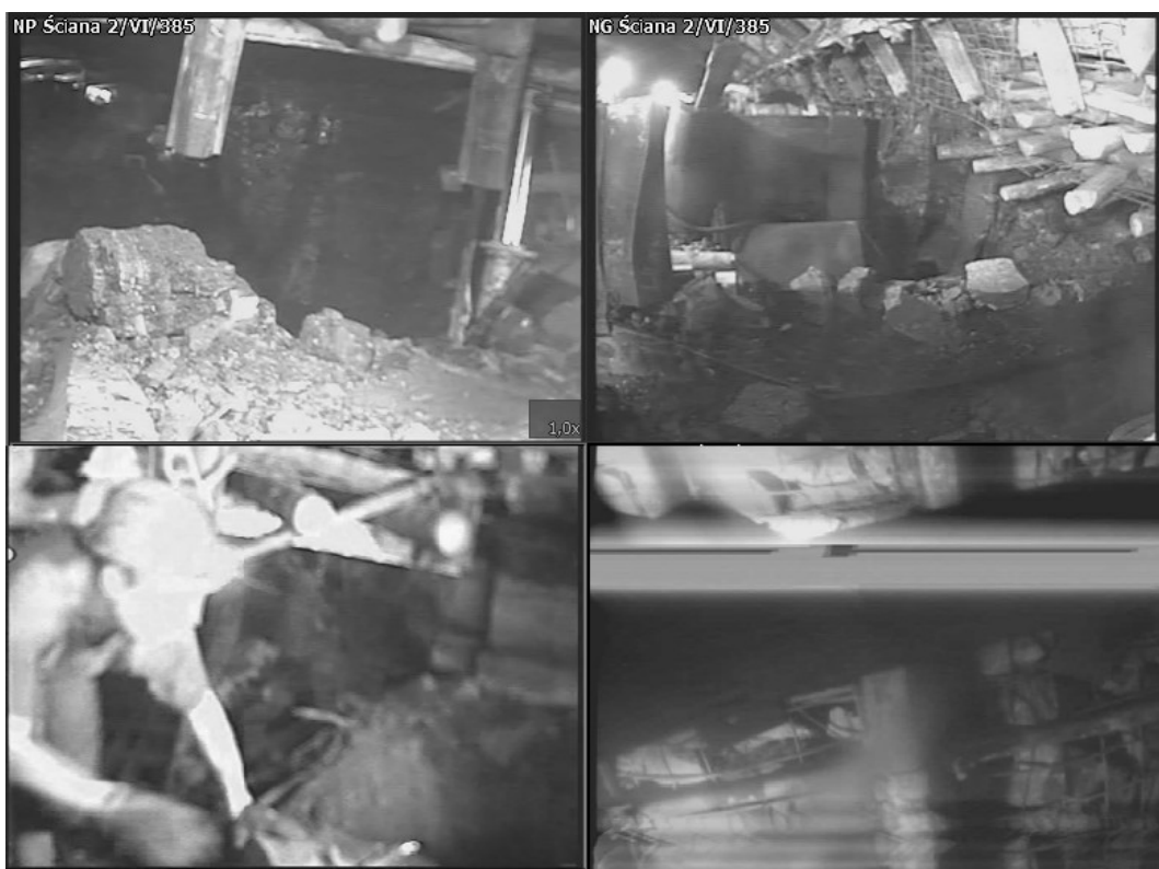
Rys. 12.11 Obraz z kamer zainstalowanych w rejonie napędów przenośnika ścianowego
