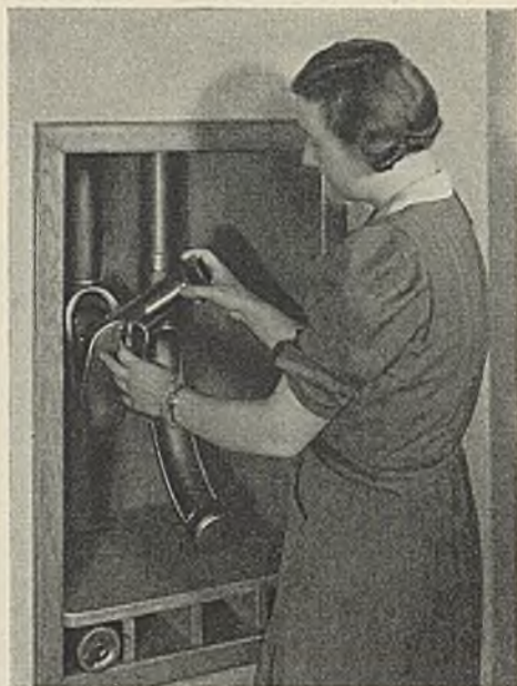
In die Wand eingebaute Station einer Rohrpost-Weichenanlage. Absenden einer Büchse.
