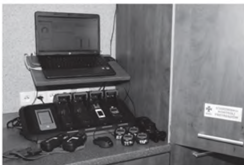
Rys. 21.7 Stacja kontroli przyrządów gazometrycznych
