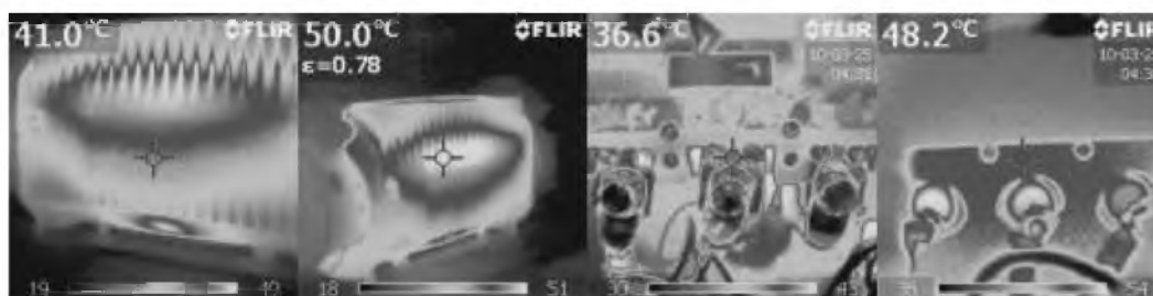
Rys. 4.3 Przykładowe termogramy przedstawiające rozkład temperatury na powierzchni obudowy, oraz zabezpieczenia przeciążeniowego transformatora It 3Sb
