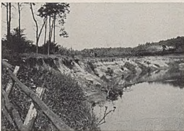
Abb. 24. Uferabbruch der Lippe bei der Rauschenburg.
