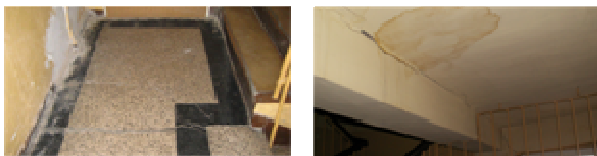
Rys. 4. Uszkodzenia klatki schodowej
