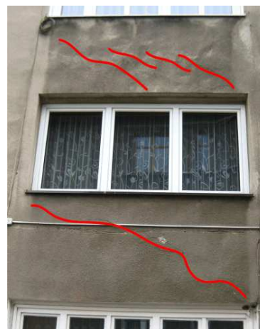
Rys. 2. Uszkodzenia ściany zewnętrznej
