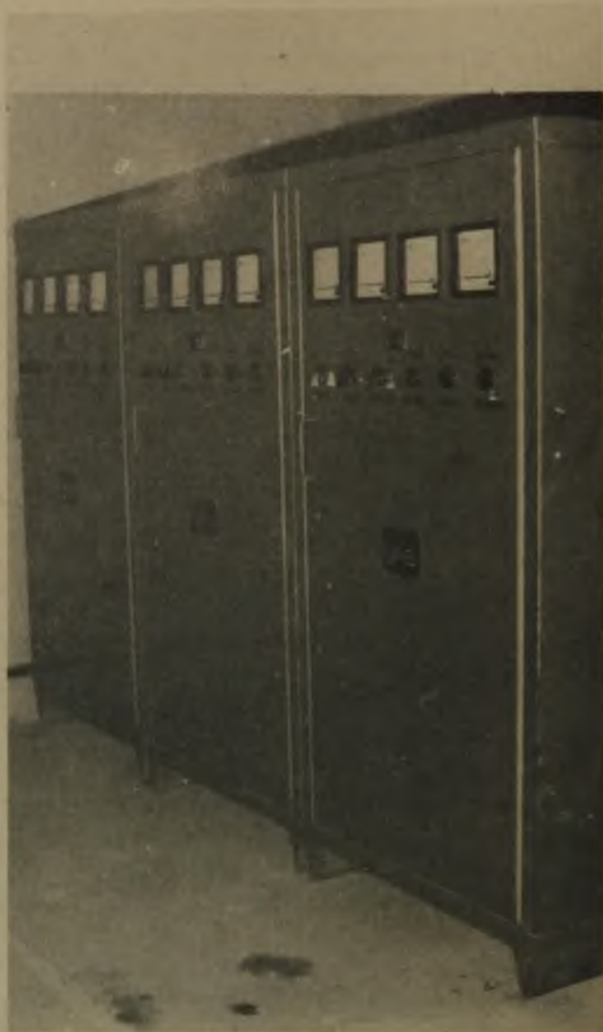
Rys. 14. Szafa sterownicza zespołu zasilającego elektro- filtry
