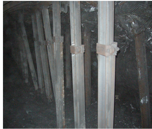
Rys. 11. Widok wzmocnienia obudowy chodnika 20a za frontem ściany w strefie oddziaływania krawędzi pokładu Fig. 11. The view of support reinforcement of roadway 20a behind longwall face in the range of impact of panel edge
