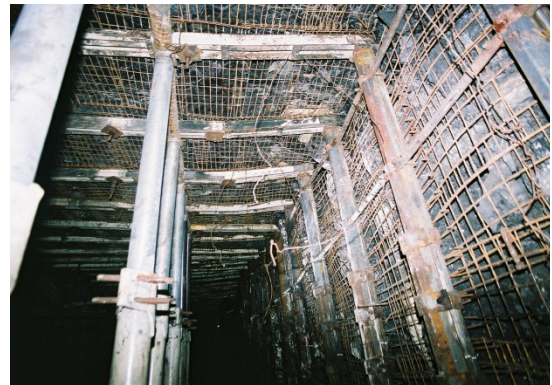
Rys. 9. Deformacja stropnicy w jej osłabionym przekroju Fig. 9. Deformation of roof bar in its weakening section
