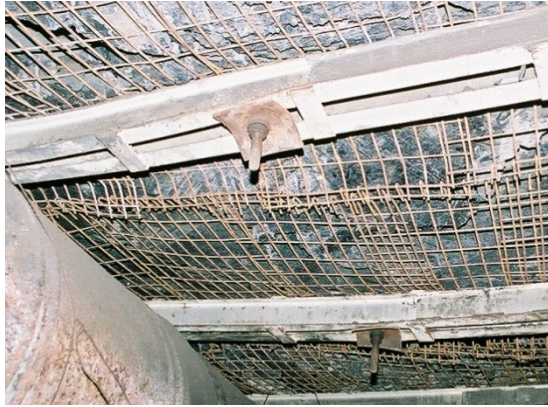
Rys. 10. Deformacja podkładki kotwiowej na podłużnej szczelinie stropnicy Fig. 10. Deformation of anchors plate AT oblong crack of roof bar
