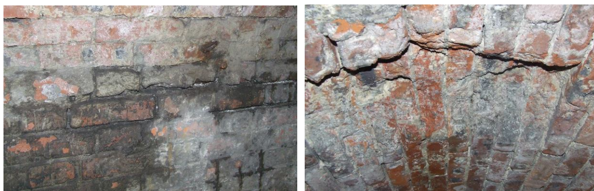
Rys. 3. Ubytki lica cegły oraz ubytki zaprawy w spoinach, spowodowane przemarzaniem obudowy Fig. 3. Losses of face of bricks and losses of mortar in joints caused by frost penetration of the lining
