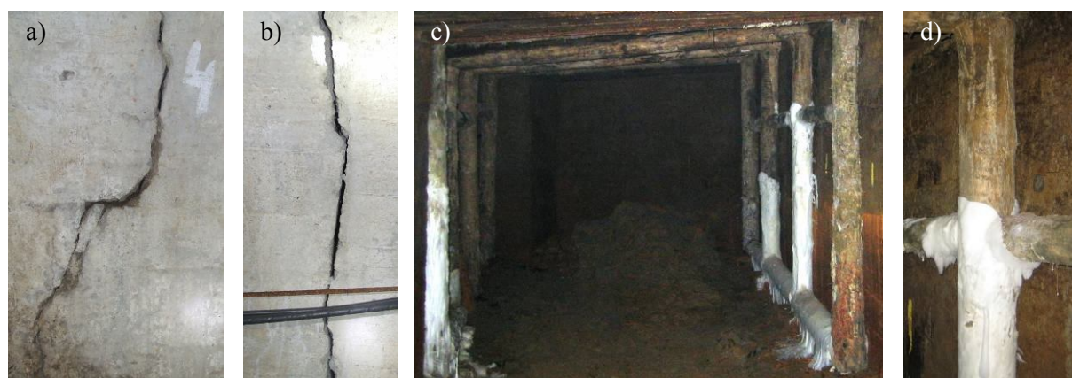
Rys. 6. Oddziaływanie czynników biotycznych na elementy obudowy: a), b) szczeliny, w których obserwowano przerastające korzenie, c), d) stojaki drewniane zaatakowane przez grzyby
