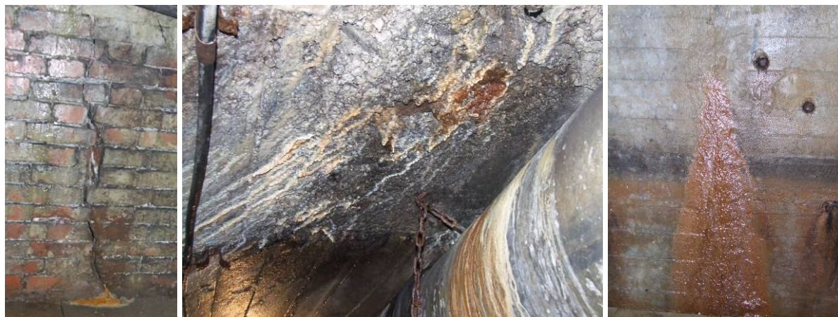
Rys. 4. Przykłady wykwitów solnych i nalotów w rejonie wycieków wody z za obmurza Fig. 4. Examples of salt efflorescence and tarnish in the area of water leaks from behind the brick lining
