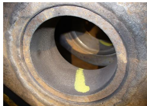
Rys. 1. Korozja wżerowa tulei Fig. 1. Pitting corrosion of sleeve
