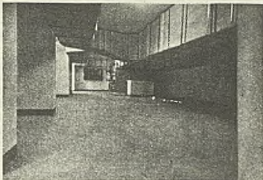
Abb. 116. Verlegte Hauptluftkanäle in einem Kellergeschoß.
