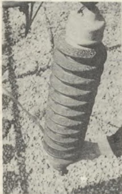
Rys. 1. Widok izolatora LPS 75/11 z pasem sterującym w rowku górnym na kloszu, zabrudzonego w naturalnych warunkach eksploatacyjnych
