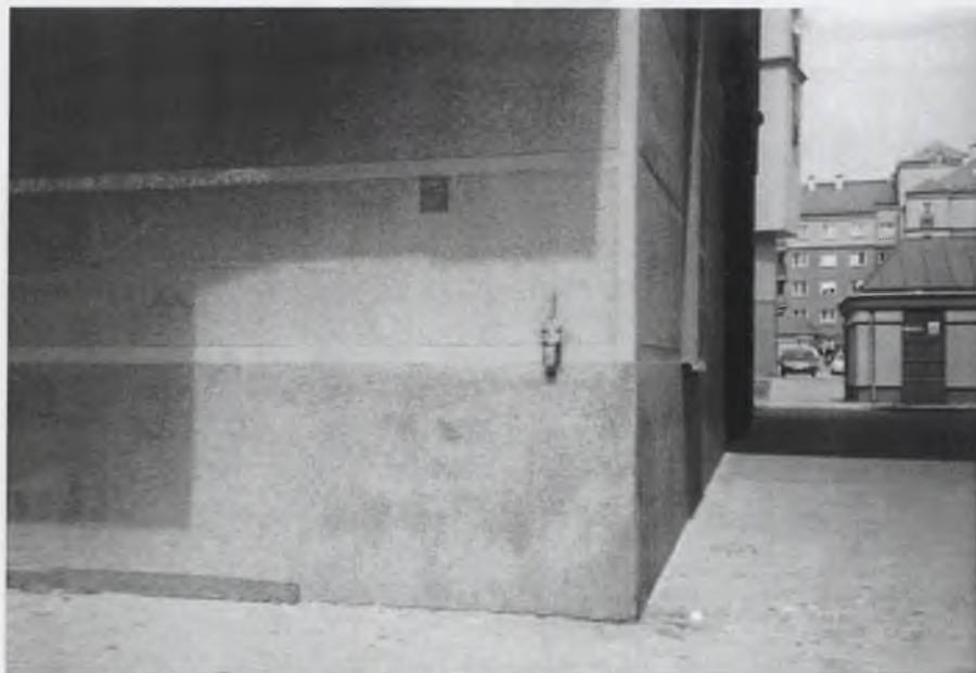
Rys. 3. Nieestetyczne uzupełnienia tynku w strefie cokołowej, fot. autor Fig. 3. Unaesthetic spackling of the plaster work in the socle, photo author
