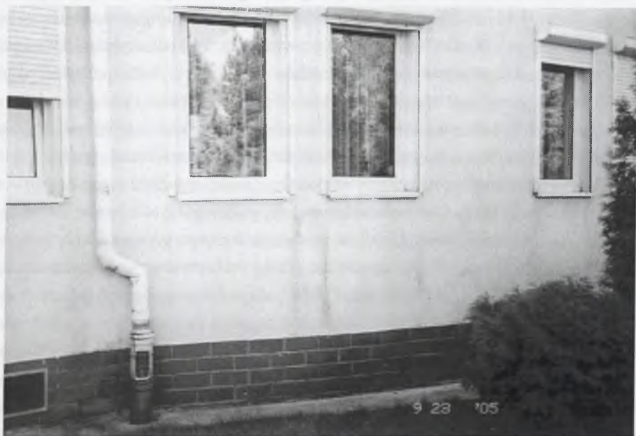
Rys. 1. Zacieki na elewacji powstające po montażu rolet zewnętrznych, fot. autor Fig. 1. Weepage on the elevation as a result of installing outer roller blinds, photo author
