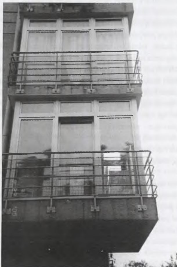
Rys. 4. Zacieki i zabrudzenia na elewacji, fot. autor
