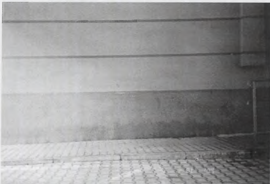
Rys. 2. Zawilgocenie strefy cokołowej, fot. autor
