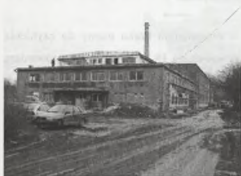
Rys. 8. Zdjęcie remontowanych budynków cechowni łaźni oraz lampowni po byłej KWK Wawel, Śląski Park Przemysłowy 2008
