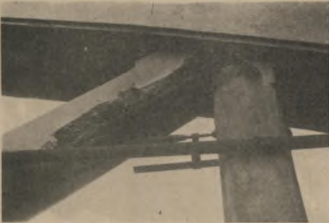
Rys-2. Charakter uszkodzeń kratownicy
