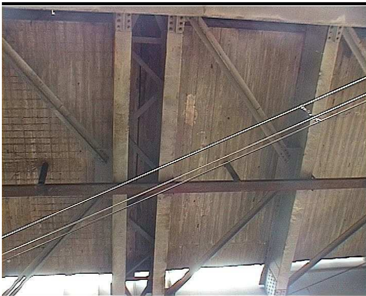
Rys. 5-9. Przęsło uszkodzone. Dodatkowy tężnik kratowy
