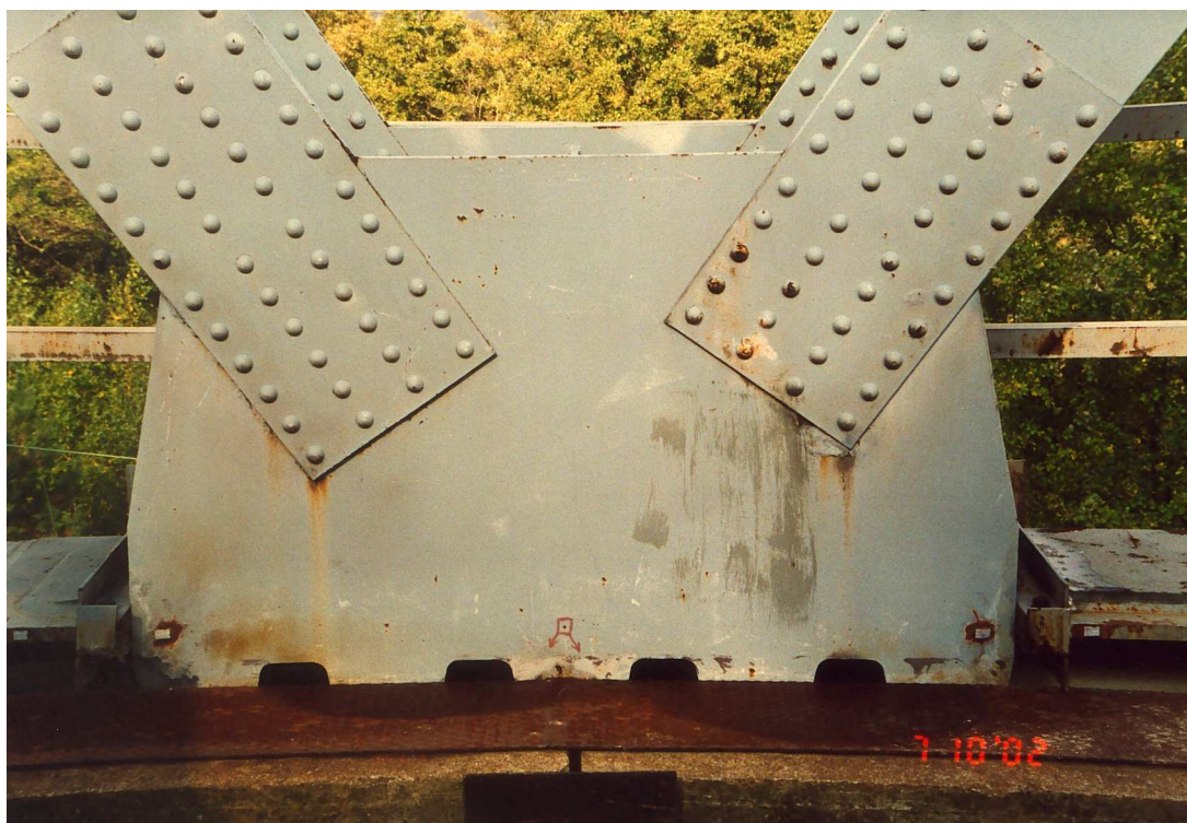
Rys. 4-4. Przęsło uszkodzone. Widok na węzeł przy przerwie dylatacyjnej w korycie
