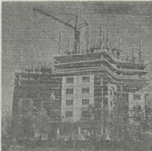
Rys. 10. 12-kondygnacyjny budynek mieszkalny realizowany metodą podnoszenia pięter w Brywaniu ZSRR; szkielet słupowo-płytowy bezryglowy montowany mechanicznymi podnośnikami z indywidualnym napędem - fot. reprodukcja z książki O. Büttner "Hubverfahren im Hochbau"
