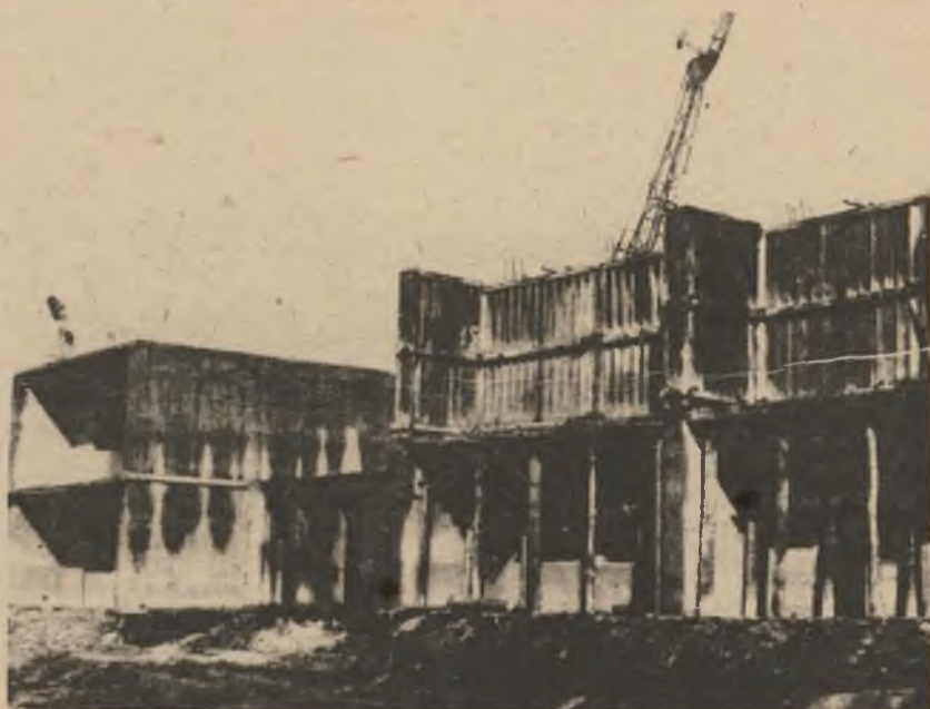
Fot. 8. Formowanie ścian piętra w urządzeniach typu GZ. Po lewej stronie fragment segmentu wykonanego w stanie surowym
