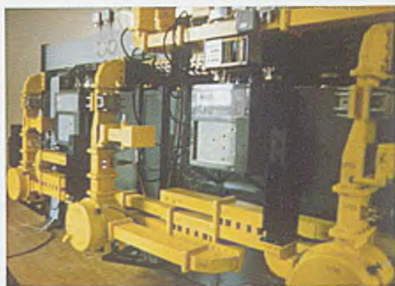
Rys. 9.4. Falowodowy trakt nadawczo-odbiorczy stacji AVIA CM
