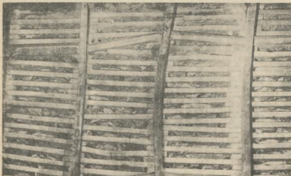
Rys. 5. Wyboczenie łuków stropnicowych odrzwi ŁS-G110 z uwagi na małą ilość rozpór
