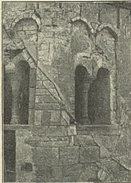
Abb. 430. Stiftskirche zu Wimpfen Südwestlicher Turm nach dem Abschlagen des Putzes
