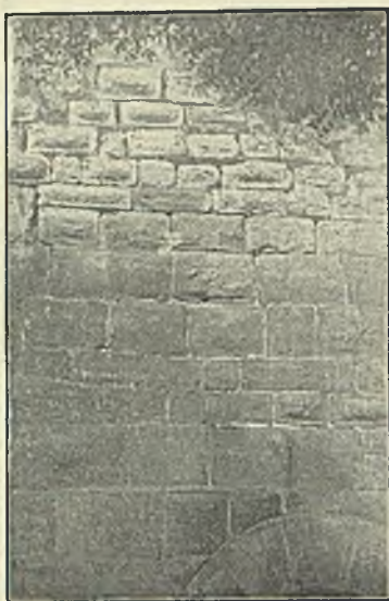
Abb. 435. Burg Steinsberg bei Sinsheim Mauerteil über dem Tore mit aus- gewaschenen Fugen
