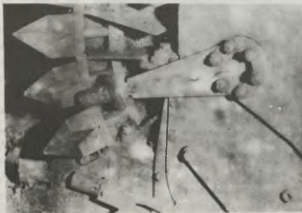
Rys. 2. Fragment hydrostruga po zdjęciu płyty osłaniającej. Widoczny wahacz z jedną dyszą i u dołu dysza stała
