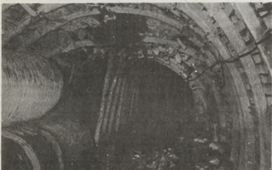
Zdjęcie 2. Widok przekopu po przejściu frontu pod przekopem. Widoczne duże ciśnienia w części stropowej przekopu
