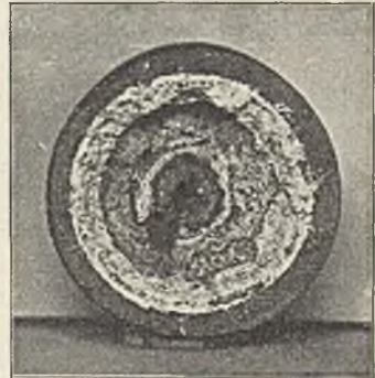
Abb. 100. Durch Kesselstein vollständig zugugesetztes Speisewasservorwärmerrohr.
